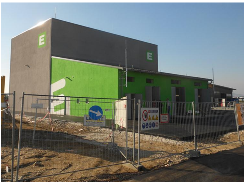
Abbildung 30: Pumpstation Feldkirchen; Quelle: Steirische Gas-Wärme
