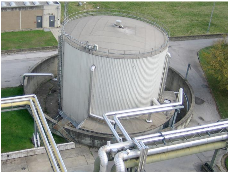
Abbildung 24: Warmwasserspeicher am Gelände der Fernwärmezentrale Puchstraße (95 MWh); Quelle: Steirische Gas-Wärme
